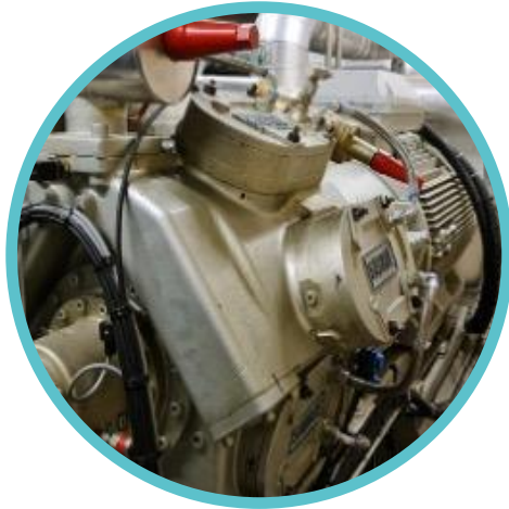
Varmepumpe som primær varmekilde
